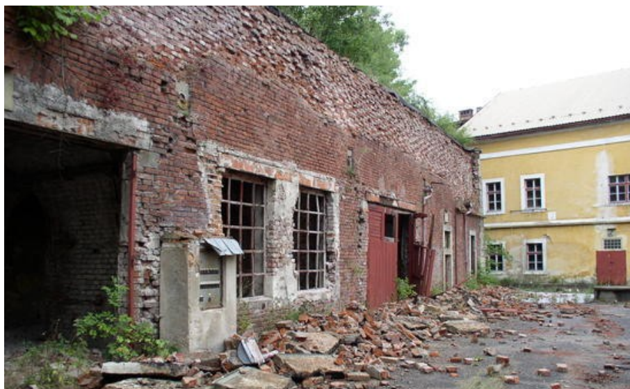
Vnitřní prostor Bastionu IV během předávání od Armády ČR. Poničené kasematy v pravé části. Zdroj: www.bastion4.cz
