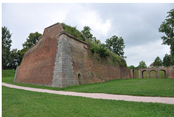
Vlevo rekonstruovaný Ravelin XVII a jeho pravé nároží, na levém lici viditelné poškození eskarpového zdiva, v pozadí pevnostní most (červen 2011). Vpravo rekonstruovaný objekt strážnice a prachárny v šíjové straně ravelinu (duben 2010). Zdroj: archiv autora.
